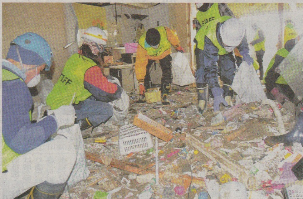
津波が突き抜けた町営住宅の部屋で、泥まみれのがれきを分別する災害支援ボランティアの人たち（宮城県南三陸町志津川で）
